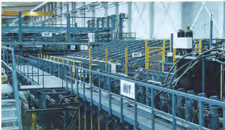
In den Rollengängen und Querförderern von H.I.T. Maschinenbau kommt Lagertechnik von Findling zum Einsatz. (© Findling)
